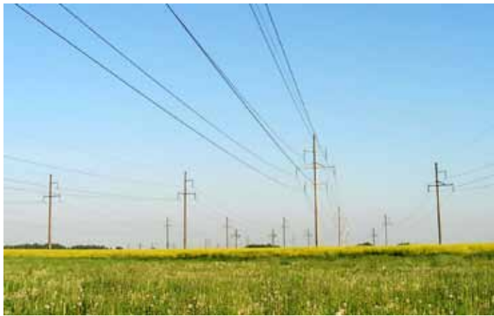
Линии электропередач на 110 кВ
